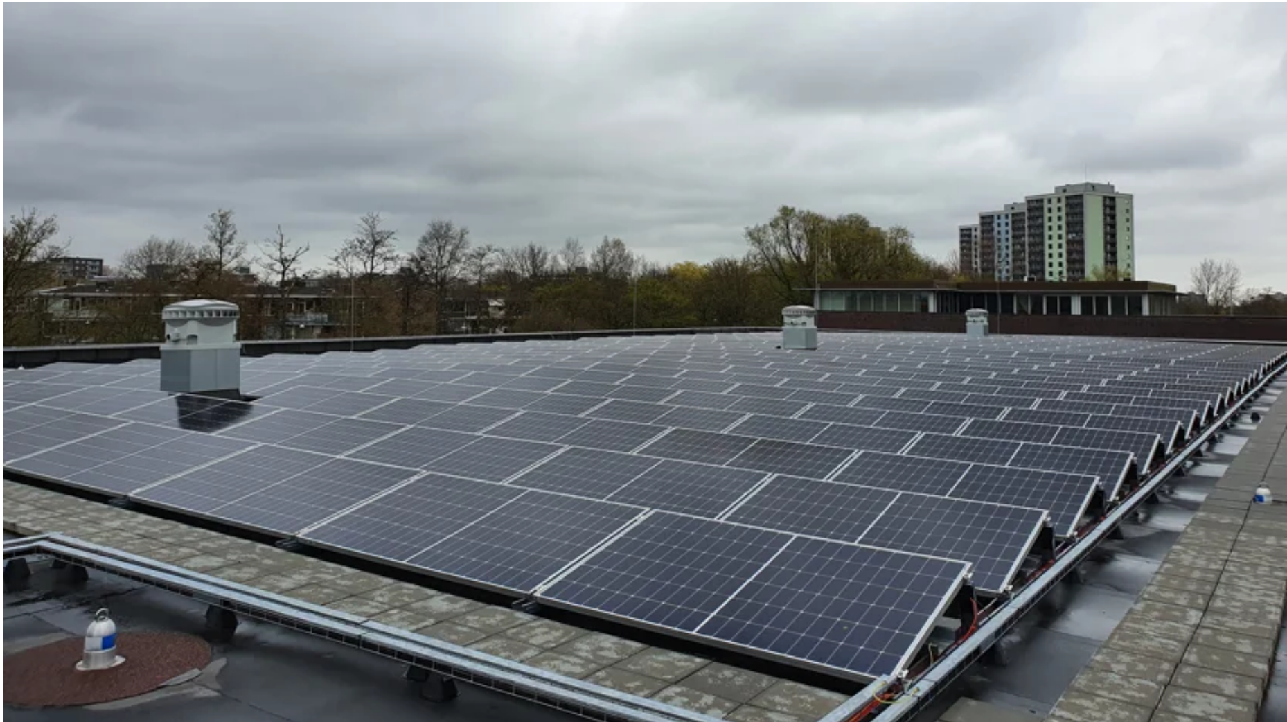
Zonnepanelen op dak van Sporthallen Diemen.
